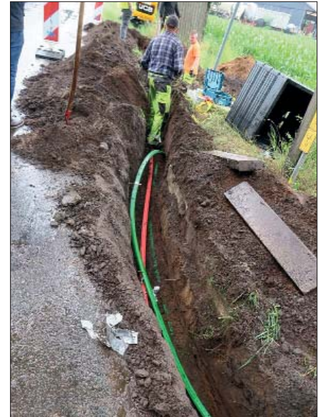
Bild 1: Mit einem Minibagger werden schmale Gräben gezogen, in denen anschließend die Leerrohre und Kabelschächte verbaut werden
