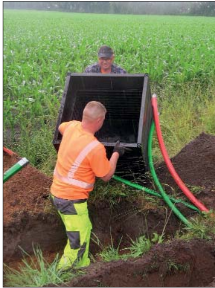
Bild 3: Die Schächte lassen sich von zwei Arbeitern ohne Hebezeug einfach und in kurzer Zeit einbauen
